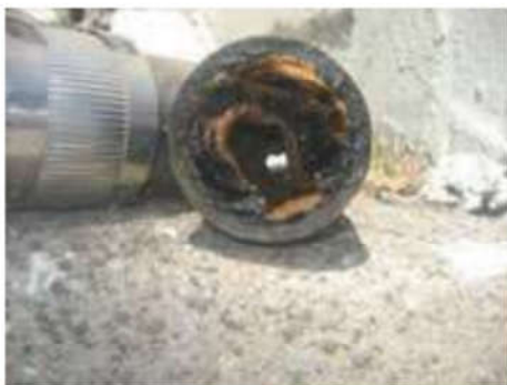
Εικόνα 1. Κατακαθίσεις λιπών σε σωλήνες
